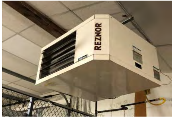
F9.1 Reznor gas-fired unit heater.
