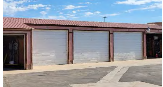
D2.1 Overhead Doors
