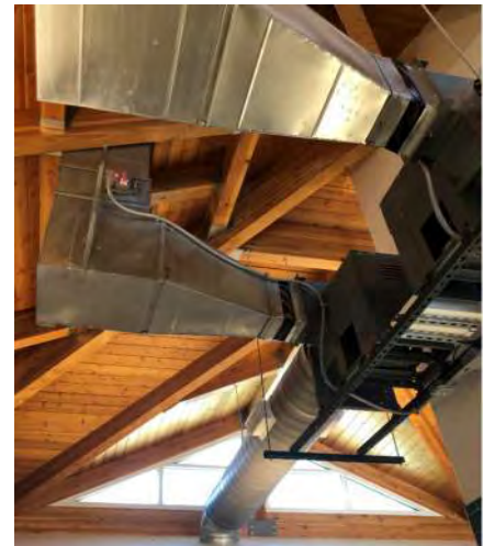
F12.1 Restroom exhaust fan
