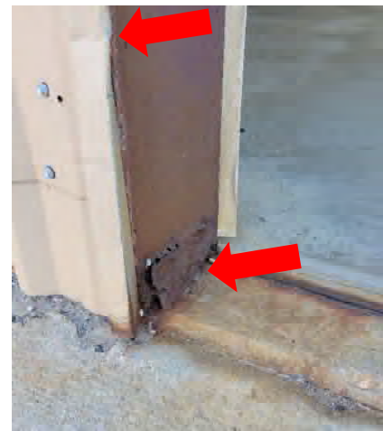
D2.2 Overhead Doors
