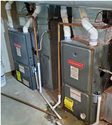
F9.1 Gas-fired furnaces.
